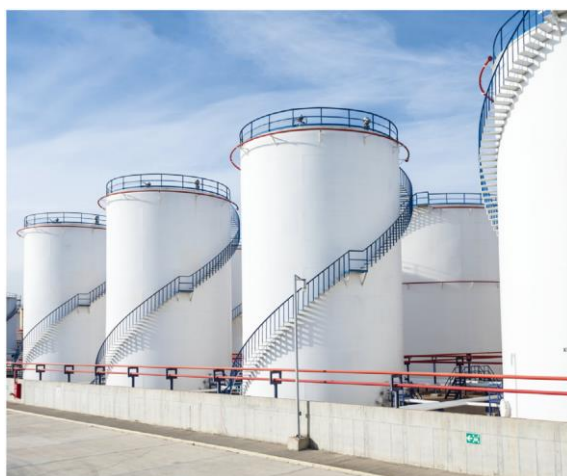
Figura 1 - Tanques de armazenamento de granéis líquidos dentro de uma bacia de contenção.
