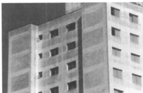
FIGURA 23.12 Fachada de blocos com problemas de desenvolvimento de microrganismos.
