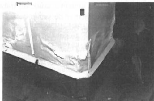
FIGURA 23.19 Parede com sinais de eflorescência em razão da existência de umidade ascendente proveniente do solo.
