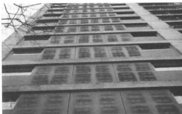
FIGURA 23.14 Fachada em concreto e poliestireno expandido com problemas de desenvolvimento de microrganismos.
