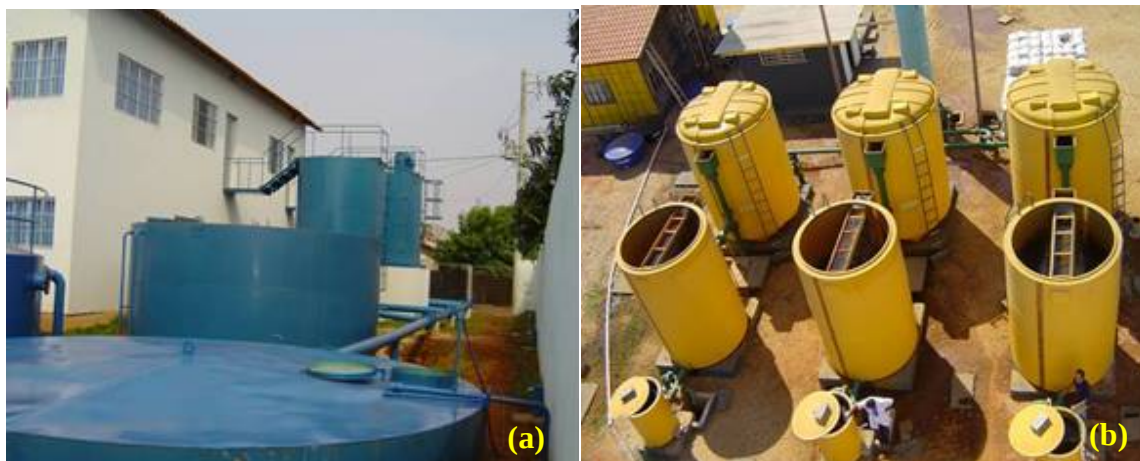
Foto 1. ETA de DF com FAP das Cidades de Cachoeira Dourada/MG (a) e ETA de DF com FAAG de São Carlos/SP (b)
