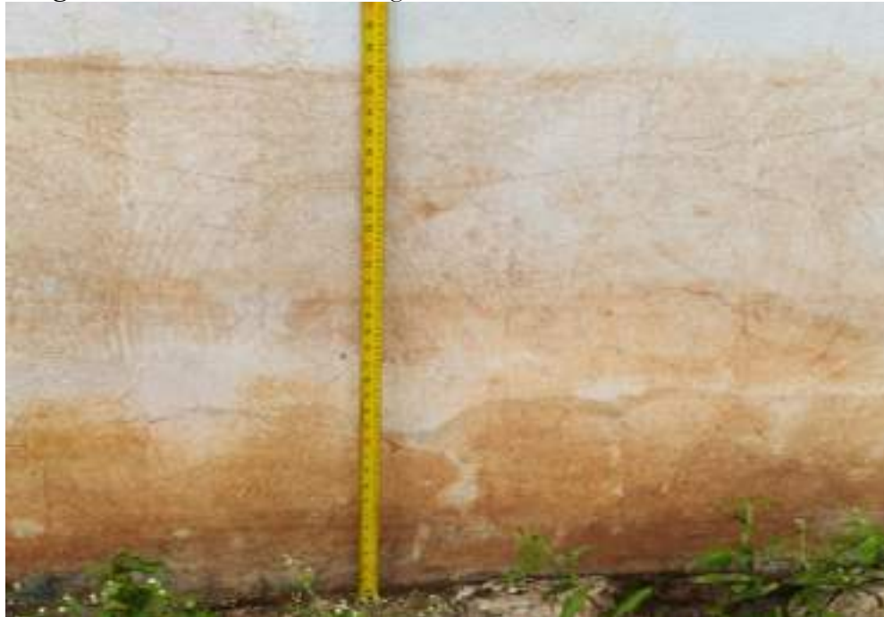
Figura 10 – Marca da altura da água na Vila Frederico
