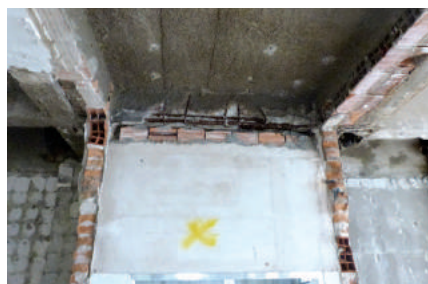
FOTO 5 – VIGA COM CORROSÃO DE ARMADURAS
