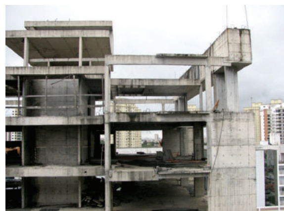
FOTO 4 – MANCHAS ESCURAS DA IMPREGNAÇÃO DE FULIGENS E PROLIFERAÇÃO DE MICRO-ORGANISMOS NA SUPERFÍCIE DO CONCRETO APARENTE DA ESTRUTURA INACABADA EM OBRA NA CIDADE DE SÃO PAULO FONTE: ARQUIVO PESSOAL DO AUTOR (TOMAZELI, 2015, P. 145)
