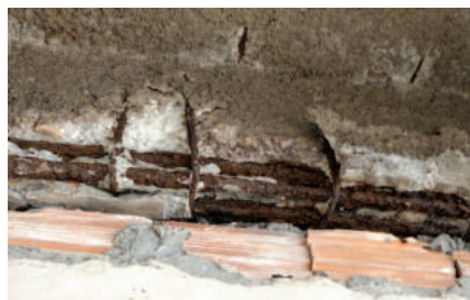
FOTO 6 – DETALHE DA PATOLOGIA DA FOTO 5
