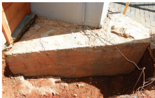
FOTO 3 – BLOCO DE FUNDAÇÃO COM REAÇÃO ÁLCALI-AGREGADO FONTE: ARQUIVO PESSOAL DO AUTOR (TOMAZELI, 2015, P. 34)
