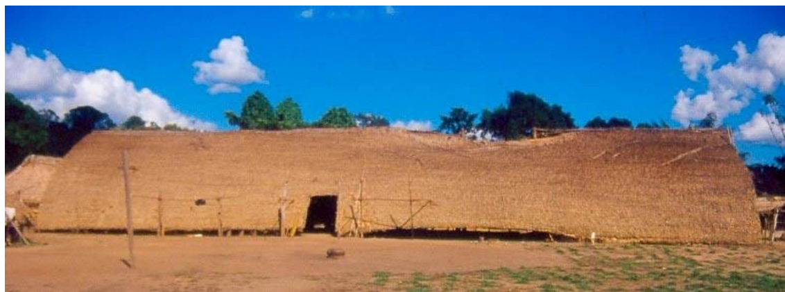
Figura 10. tavyva Kwatinema em processo de deterioração (2005).
