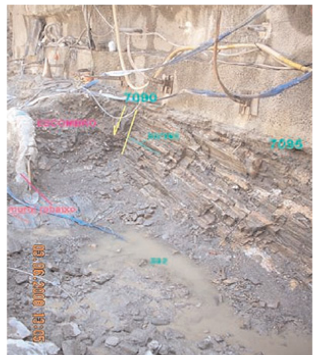
Figura 17 - Aspecto da superfície serrilhada de ruptura. Vista do sentido do poço à direita, parede ao lado da Abril
